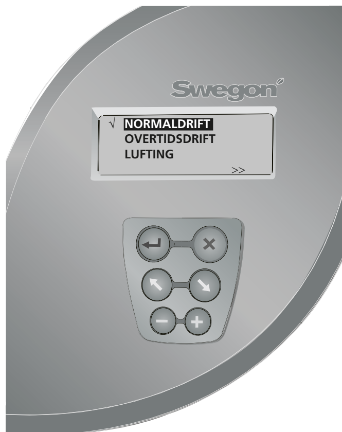
Styredisplayet er montert på aggregatets inspeksjonsdør.
